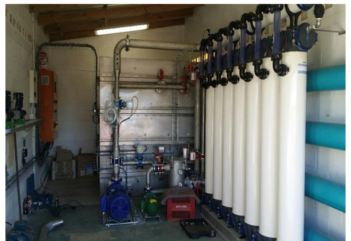
Voorstekraal Package Plant
